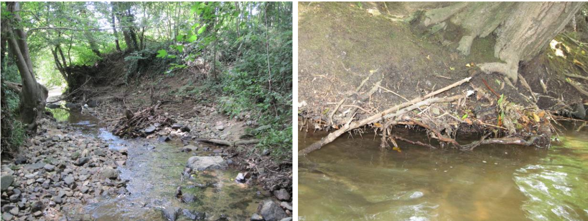
Figures 8 et 9 : Erosions sur le Mornantet à Mornant (Source : BRLi)
